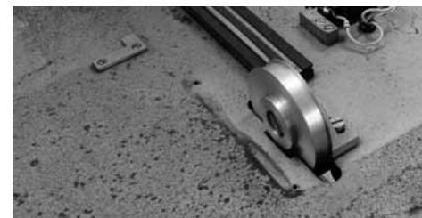
Photo 6: Corrosion par piqûres, poussière et anciens produits de protection sur la face supérieure de la table n° 3
